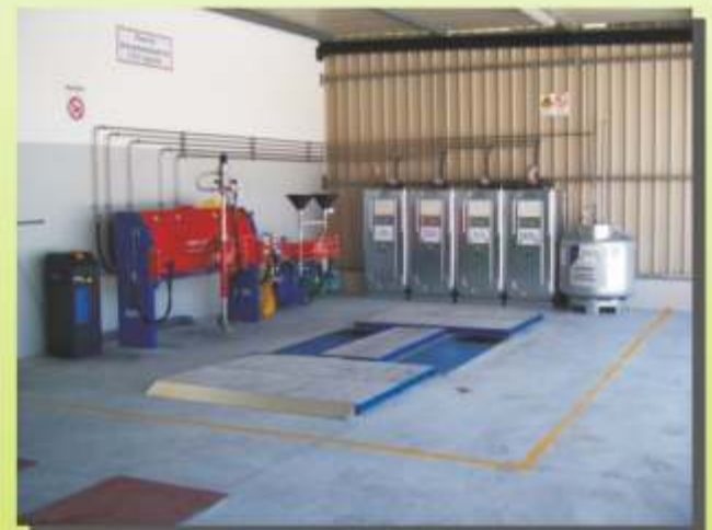
Estação SEDA EASY DRAIN V3 c/ elevador RODAPEÇAS - Z. Industrial Caldas da Rainha
